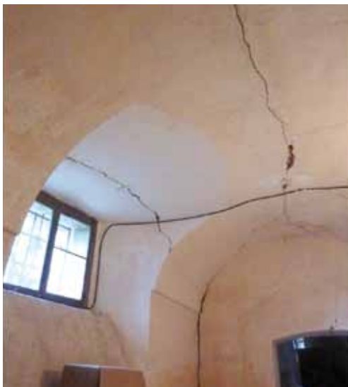
Dettaglio della profonda fessurazione longitudinale.
