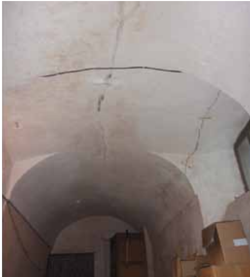
Vista della volta di copertura e del quadro fessurativo.
