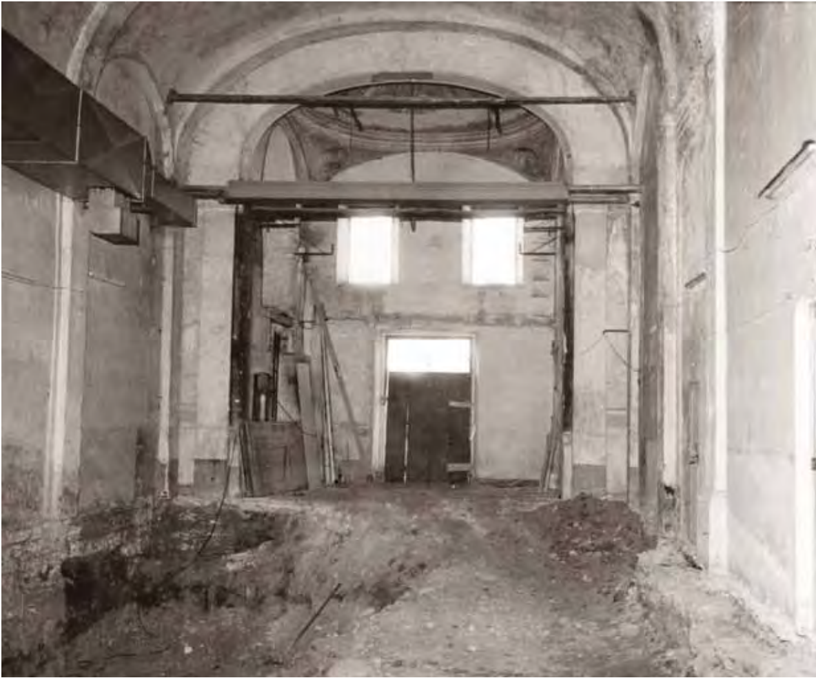
La navata e il presbitero della precedente chiesa di S. Martino, durante i lavori di recupero degli ambienti, 1988
